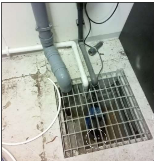
Mätpunkt 5, inomhusluft. Ventilationsrum i padelhallen, mätaren hängdes i gammal golvbrunn.
