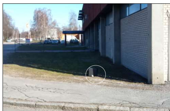
GV-rör vid byggnadens sydvästra hörn, trasigt och inget lock. Rördjup 2 meter, gvy fr ök rör 1,25.
