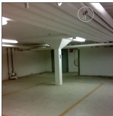
Mätpunkt 6, inomhusluft. Teknikrum i slutet av korridoren som kallas "suckarnas gång". Källarplan. Avgaslukt i korridoren.
