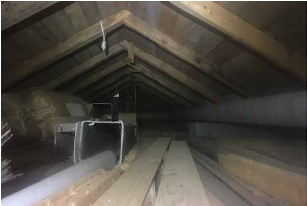
Vinden, den runda komponenten till höger i bild är ett ventilationsrör. Takstolar och undertaksbrädor består av gammalt virke, förmodligen återanvänt från Sockenstugan
