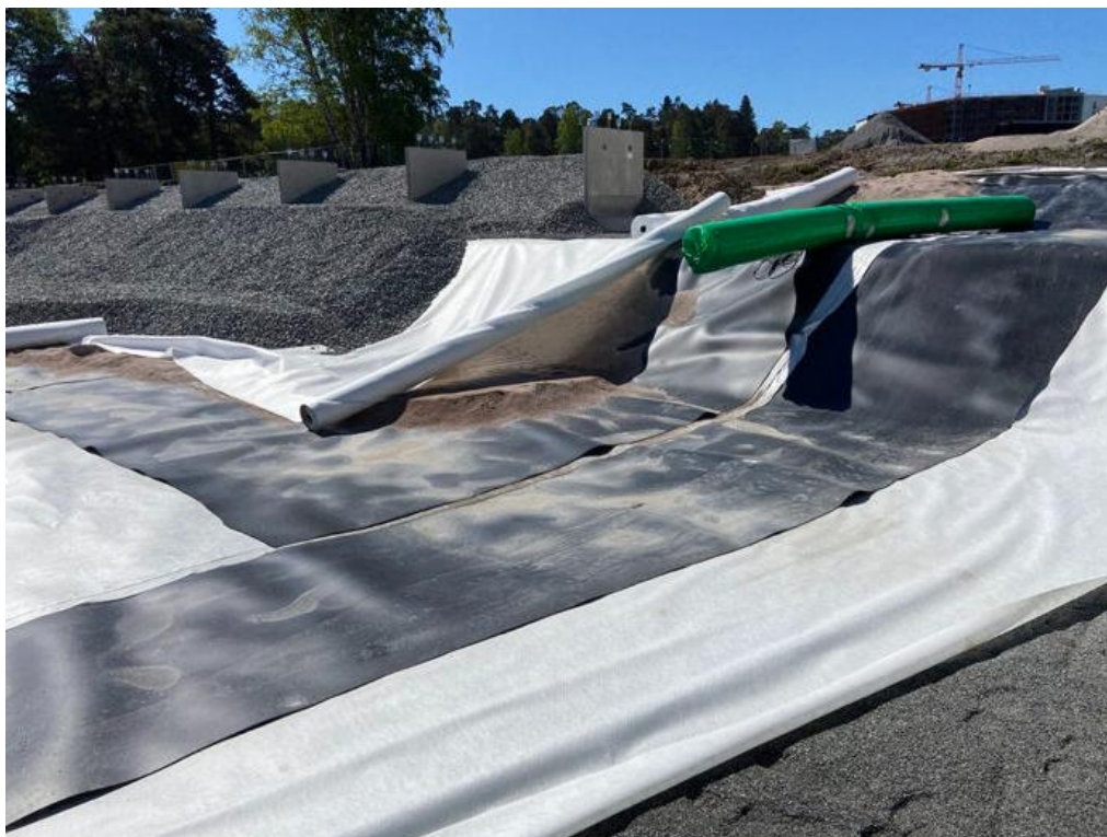
Figur 25 Anläggning av damm med tät duk i Polacksbacken, Uppsala (VA-guiden, 2020). Vitt – geotextil, svart – tät duk.
