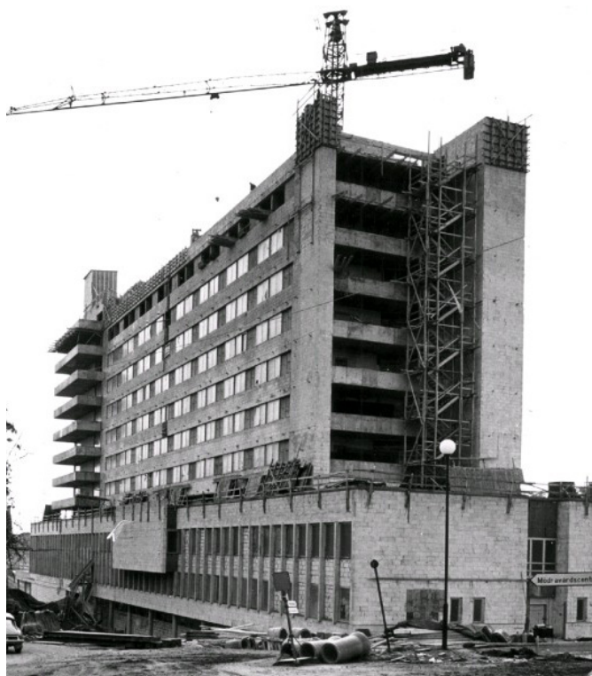
Lasarettets höghus under uppförande 1967. Arkitekt var Leo Uulas. Källa: Sörmlands museums samlingar.
