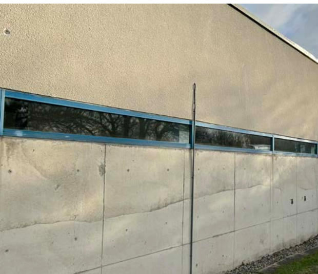
Ut mot Brunnsgratan har det tidigare fritidscentret och terapidegen en långsmal fönsterslits med blå färgkodning. På insidan löper en förbindelsegång.
