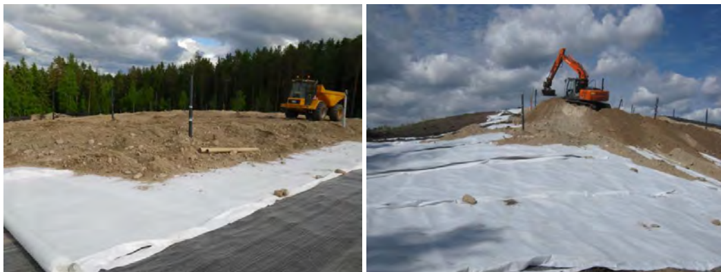
Figur 20. Illustration av sluttäckningskonstruktion (bentonitmatta som tätskikt, dräneringsmatta som dräneringsskikt och morän/jordmassor som skyddsskikt).
