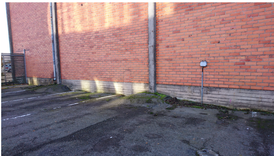
Figur 1. Sättningar intill pålfundament vid byggnader i norra delen av området, fotografi taget vid platsbesök 2017-11-06.
