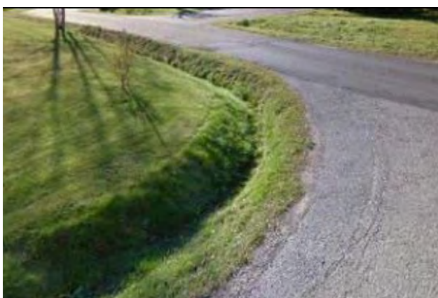
Figur 18. Exempel på ett mindre svackdike i urban miljö. Källa Kretslopp och Vatten, Göteborgs Stad.
