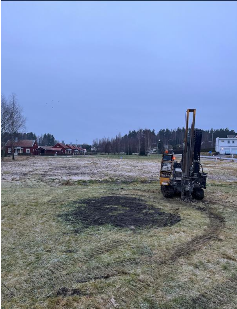
Figur 2. Bild tagen över undersökningsområdet vid undersökningstillfället. Bilden tagen från punkt 23GW10 i riktning mot sydväst.
