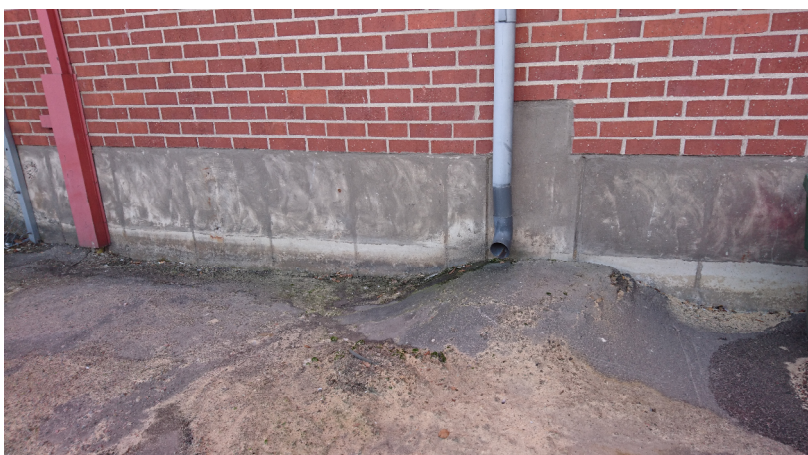
Figur 8. Sättningar i anslutning till byggnader i norra delen av undersökningsområdet, 2017-11-06.
