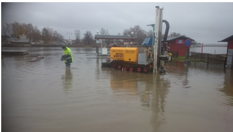
Figur 7. Översvämning i östra delen av området vid Sjömacken, 2017-11-21.
