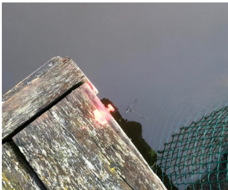
Figur 6. DUBBVTN1, installerad i brygga, 2017-11-20.
