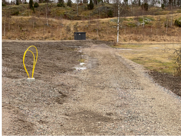
Figur 5. Foto på delsträckor D (rakt fram) och E (från sidan till transformatorstation) 2022-01-01.
