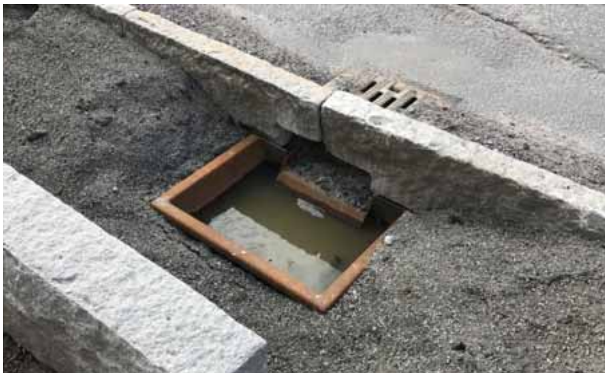
Figur 10. Anläggning av inloppsbrunn till planteringsyta med gallerbetäckning och spridningskär. Foto: A. Thorsell Structor Uppsala AB.
