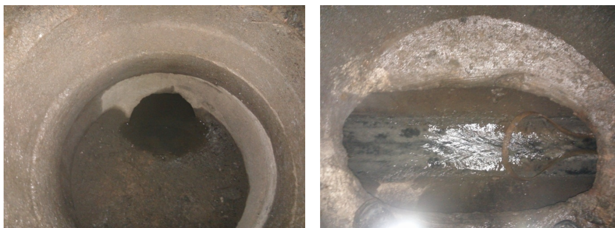
Figur 2. Fotografier från två nedstigningsbrunnar tillhörande dag- och spillvattensystemen i Brunnskatan. I dagvattenbrunnen DV2 till vänster syntes enbart stillastående vatten i den vattengång som leder söderut mot DV1. I spillvattenbrunnen DV3 till höger har vattenflödet bedömts uppgå till cirka 200 liter per minut.
