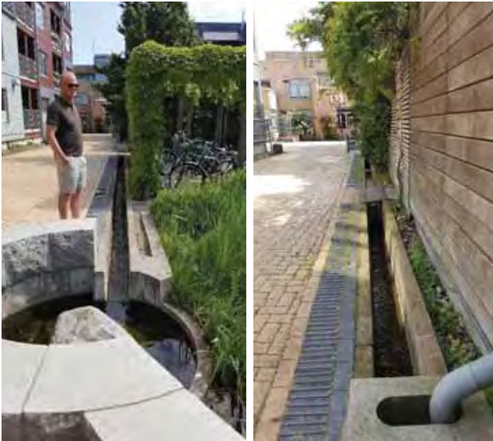
Figur 8-32: Visar utloppet från växtbädden och hur dagvattnet leds vidare förbi huskropparna och tar emot dagvatten på vägen. Vattnet rinner sedan ut i ytterligare växtbäddar och multifunktionella ytor. Foto: Structor
